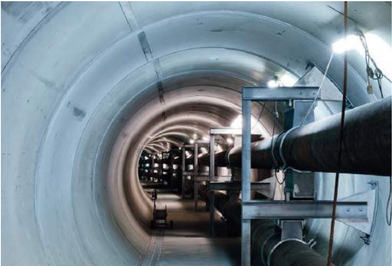
Begehbarer Fernwärme-Kanal von Energie Wasser Bern
