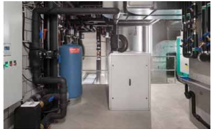
Innenansicht Küche Haustechnikzentrale BSR_07_1007_AF017
